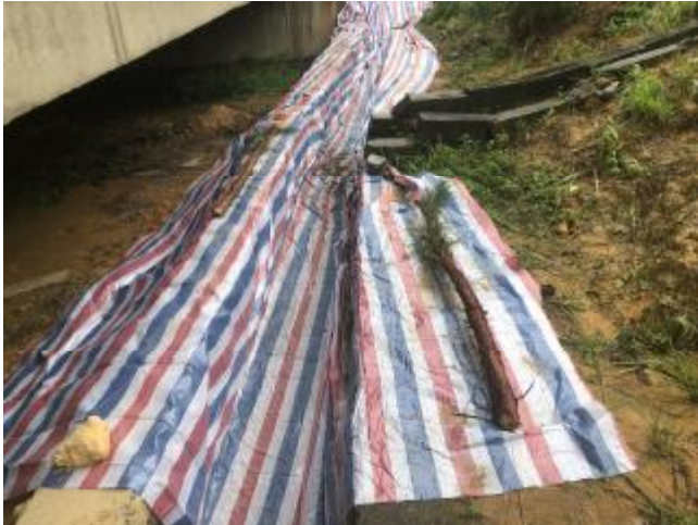
图 3 坡顶水沟损毁
